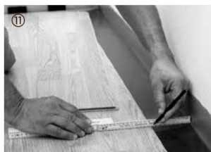
Elementerne i sidste række skæres til i længderetningen med en ekspansionsafstand på 10–15 mm og indpasses.
